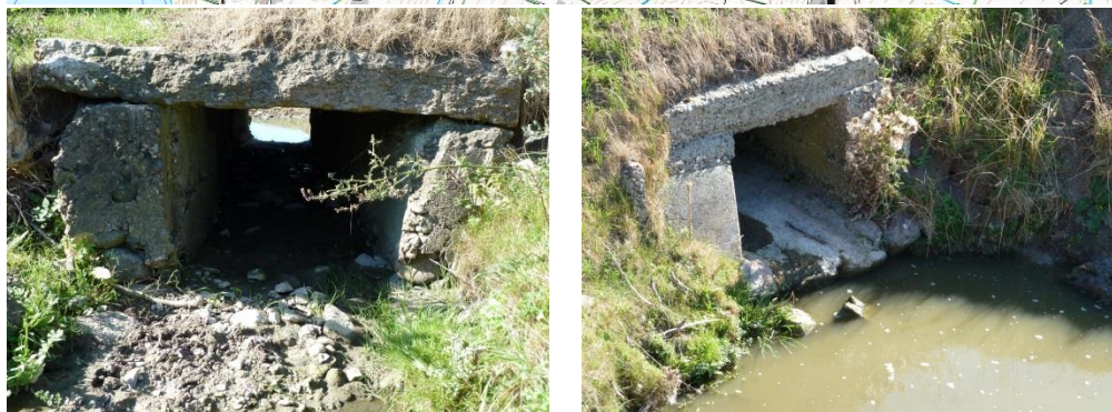
Figur 1.1: Spærring AAL-1154. Overkørsel med et kraftigt fald gennem overkørslen og et faldbrud på udløbssiden. Vandløbet var tørlagt på besigtigelsesdagen (26. august 2013). Nedstrøms overgangen var der samlet vand, da de store afstrømninger giver anledning til en erosion af bunden.
